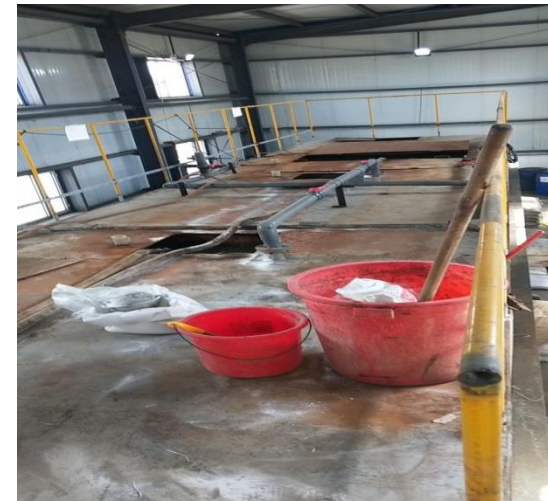
大昌汗镇郭家湾污水处理站
